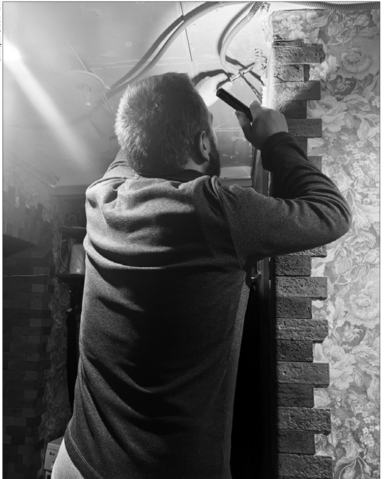
После залива квартиры в проводке произошло короткое замыкание.
