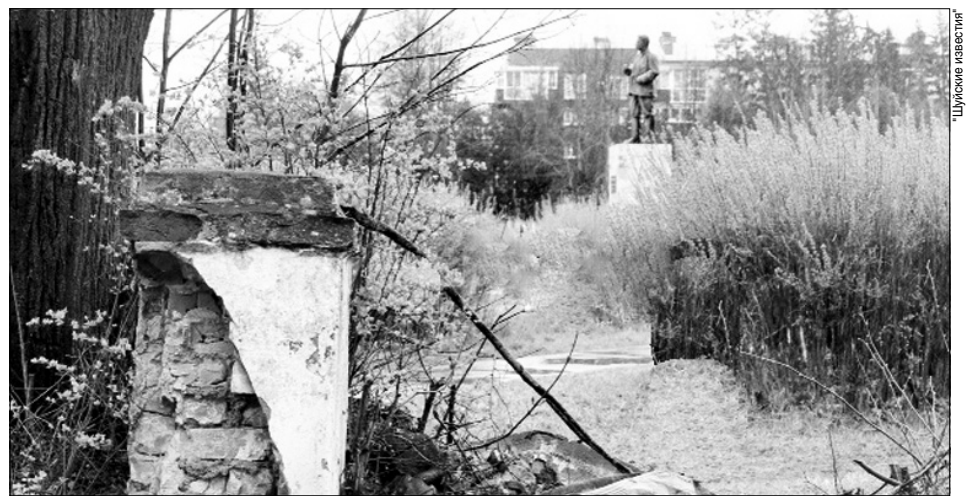
Деревянная часть ограждения сгнила, а кирпичные столбики-опоры развалились.
