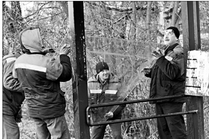
В Кинешме вставляют стекла, разбитые хулиганами на новых остановочных павильонах.
