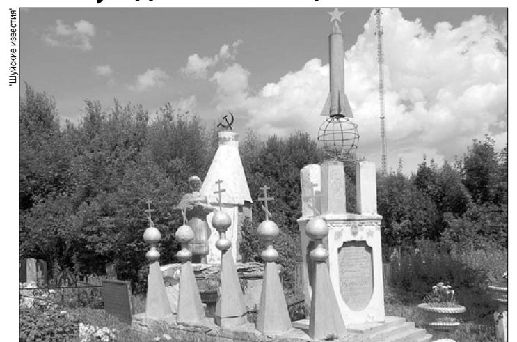
Мемориальный комплекс остро нуждается в ремонте: постамент стал щербатым, некоторые памятные доски отвалились, плиты крошатся.
