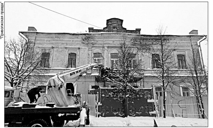
Аварийные ограждения балкона убрали до ремонта.
