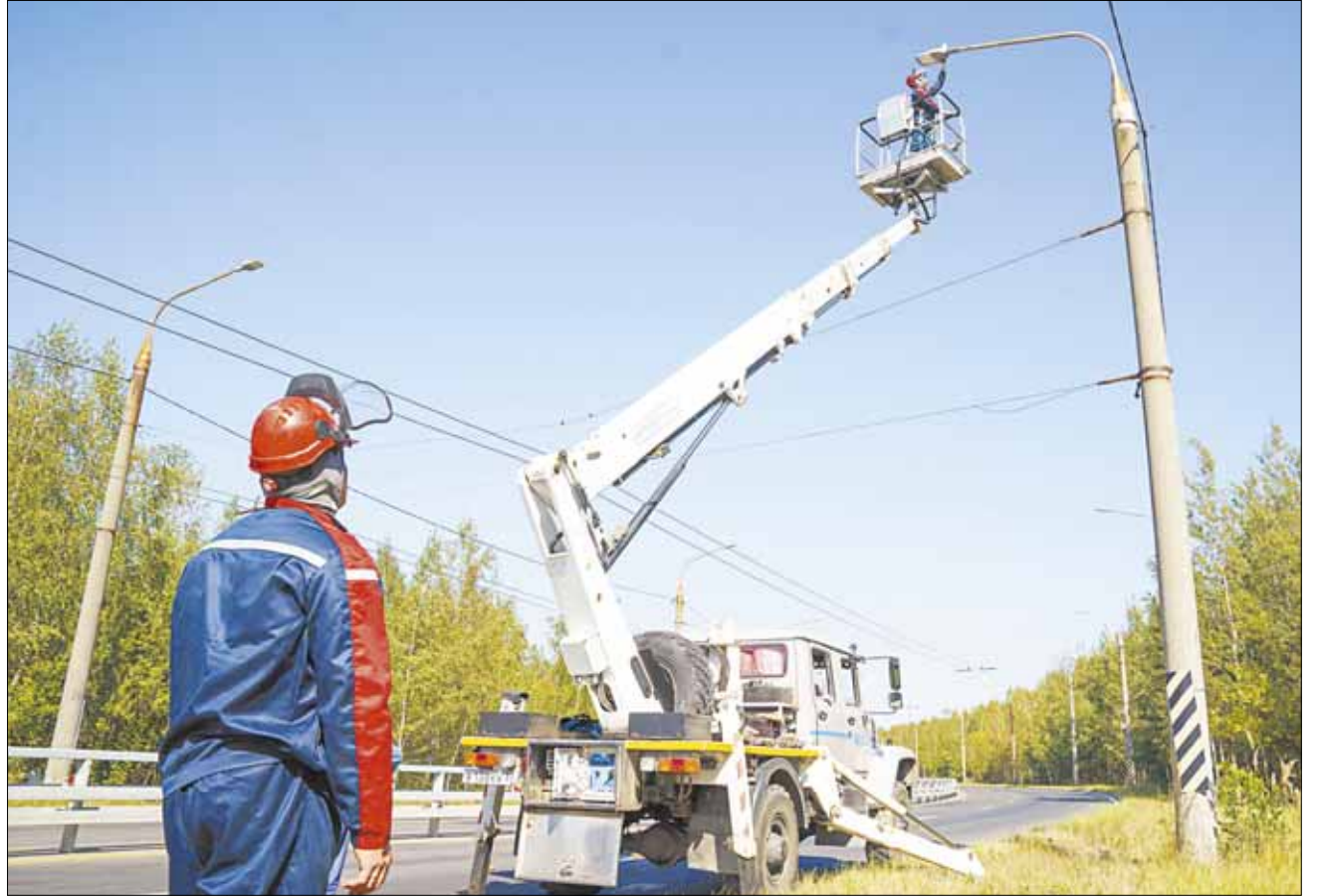
Ежедневно в круглосуточном режиме специалисты обслуживают по области свыше 19 тысяч километров линий электропередач.
