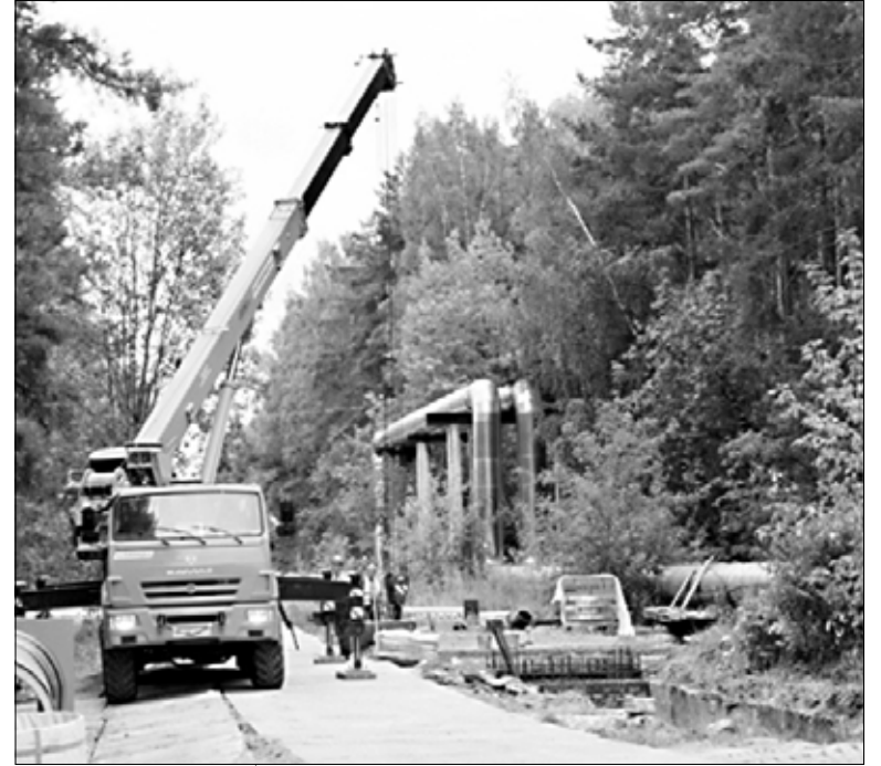
Данная тепломагистраль обеспечивает тепло и горячей водой практически весь Ленинский район Иванова.
