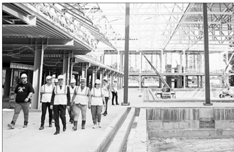
Дворец водных видов спорта — один из самых больших строящихся объектов в области. Он будет соответствовать всем мировым стандартам.
