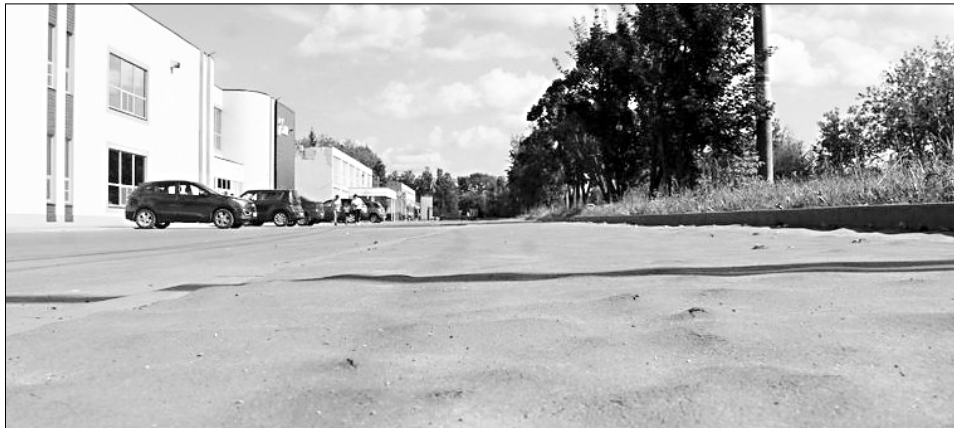
Некачественный асфальт укладывал собственник спортклуба.
