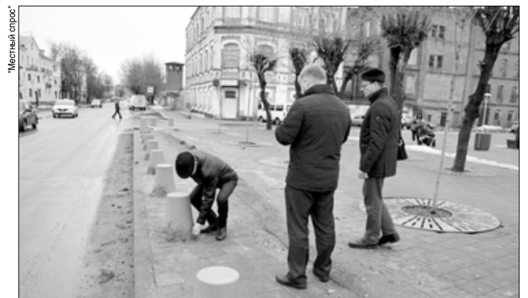
Не простояв и полгода, заградительные столбы начали разрушаться.
