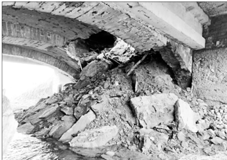
Вид на Хреновский мост снизу ужасен.
