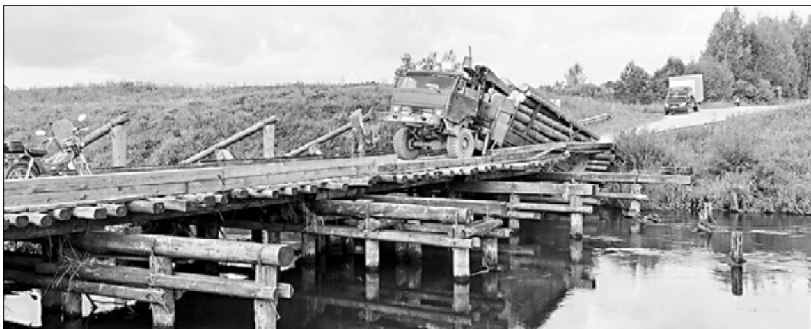
Этот объект у Мирславля в прошлом году разрушил лесовоз, департамент дорожного хозяйства его отремонтировал.
