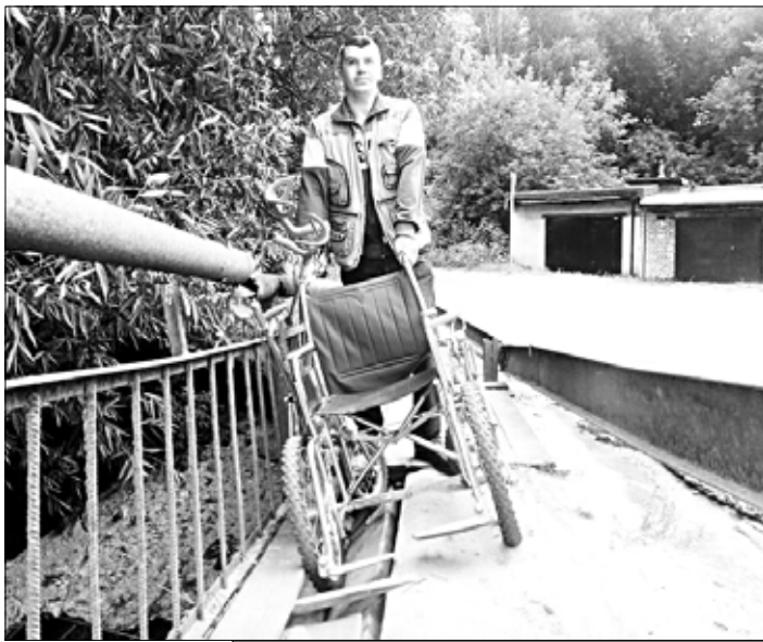
Мост через Казоху нуждается в срочном ремонте.
