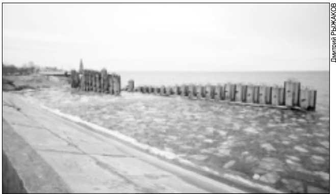
Вода подходит под основание дамбы.
