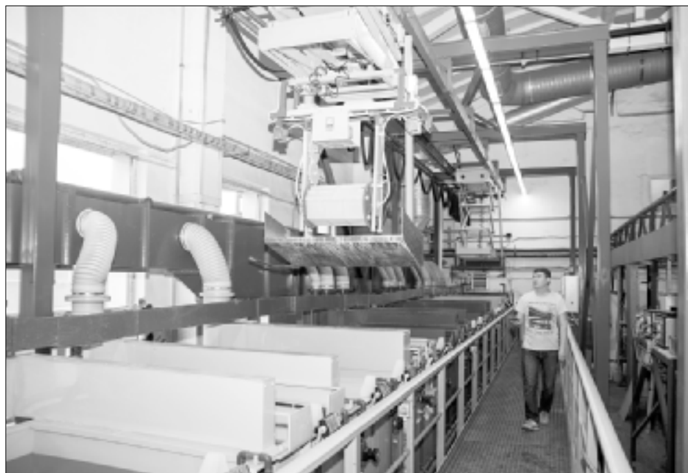
В 2017 году был открыт новый гальванический цех.
