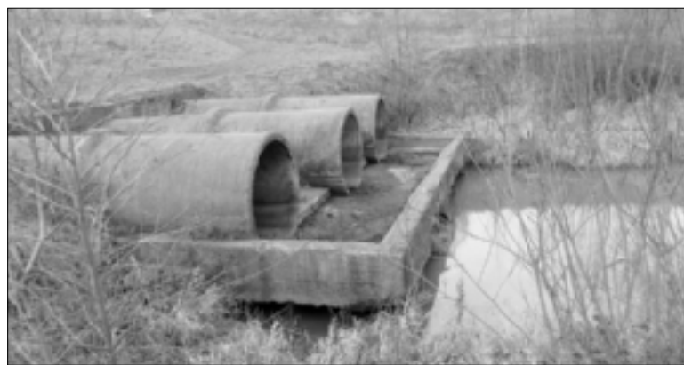
Сливные трубы прошли испытание временем, а рядом – заросли кустарника.
