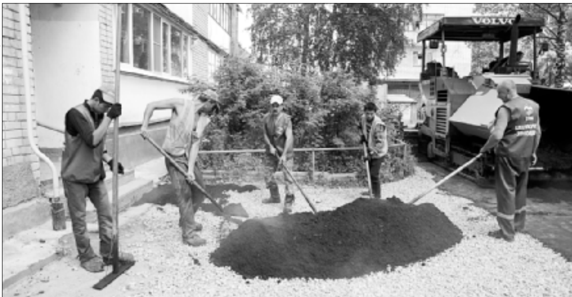
Укладка асфальта — еще не гарантия отсутствия луж.
