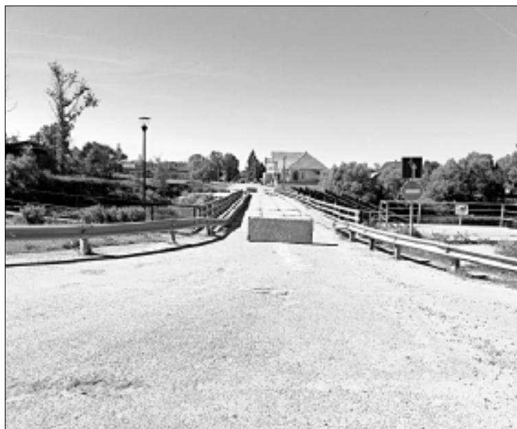
Мост через Тезу в Холуе снова стал опасным.
