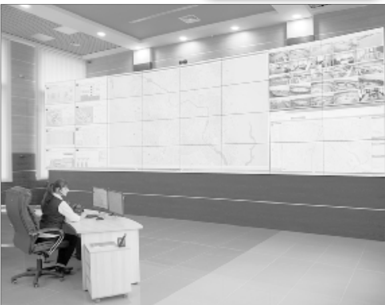
«Водоканал»: зал управления на проспекте Строителей похож на космический ЦУП.
