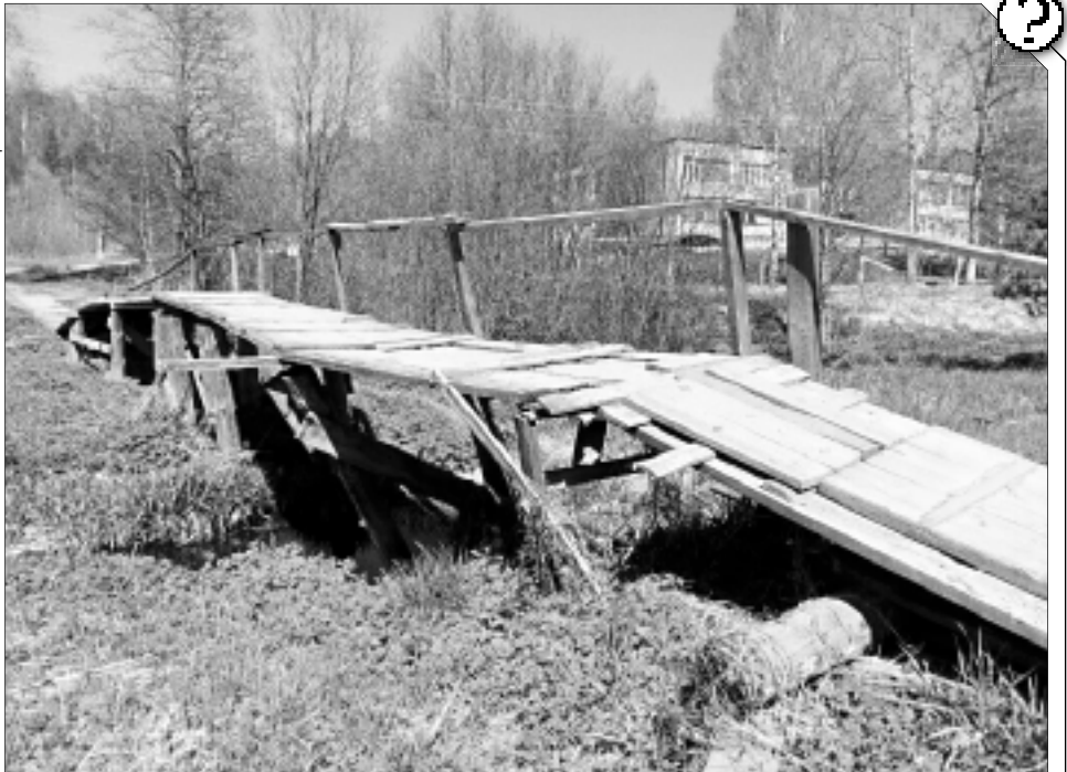
Про этот мост пешеходам лучше пока забыть.
