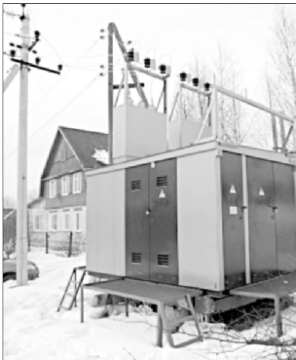
Трансформаторная будка, где случилось несчастье.
