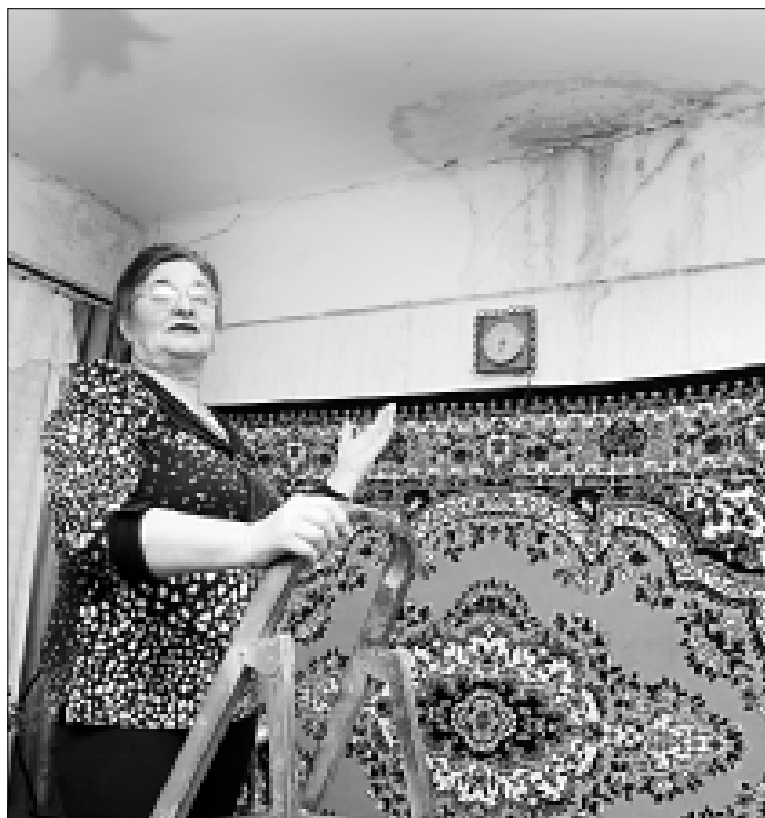
Протечку крыши должны устранить в течение суток, сделать ремонт в квартире — в течение месяца.
