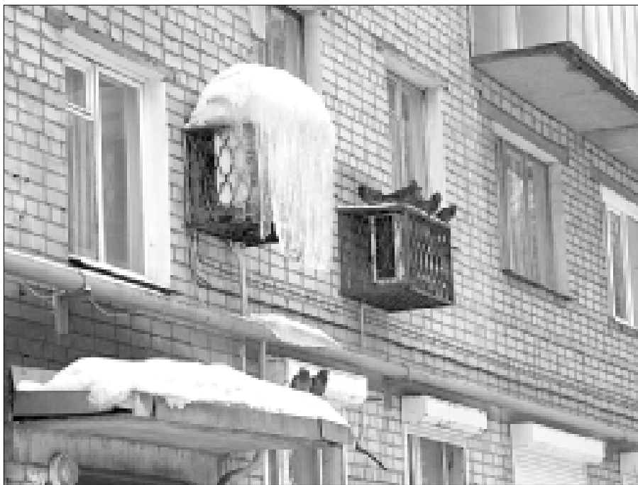
Такой тяжести даже козырек крыльца не выдержит.
