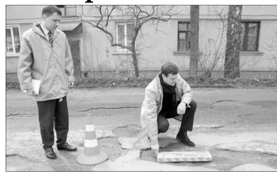
— На улице Новой в Иваново «колобашка» тонула в ямах.
