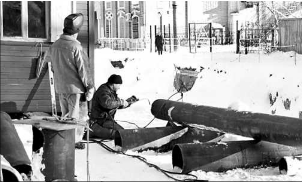
Деньги, которые задолжали организации филиалу «Т Плюс», могли бы пойти, к примеру, на ремонт тепловых сетей.
