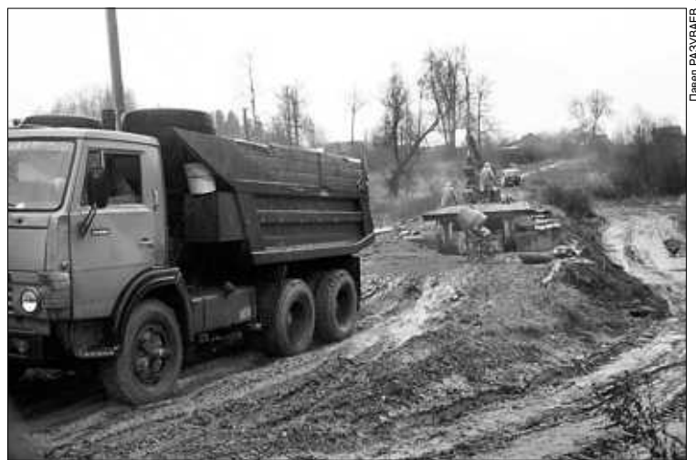
Такие дороги в районах области еще нередки. Их ремонт обходится очень дорого.
