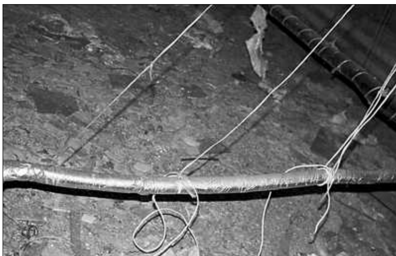
Надежность труб в подвале дома в Пограничном переулке вызывает вопросы.
