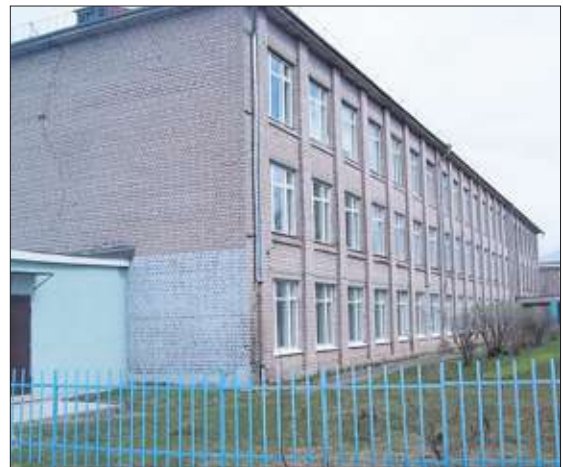
Вместо разрушающегося здания Савинской школы будет построено новое. На другом месте.
