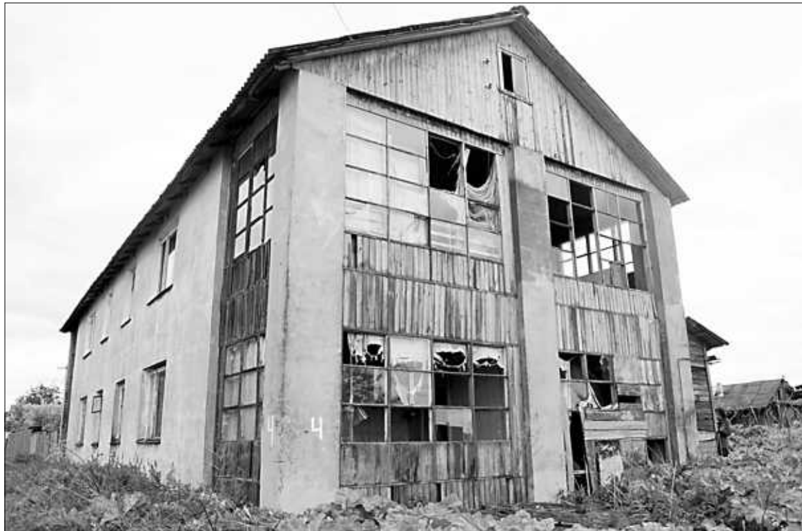
До ремонта крыши в 2042 году дом может и не дожить.
