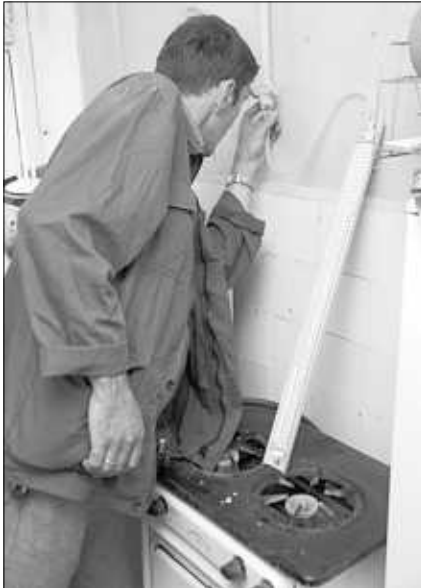
▲ Самовольная установка и подключение газовых колонок и плит могут привести к печальным последствиям.
