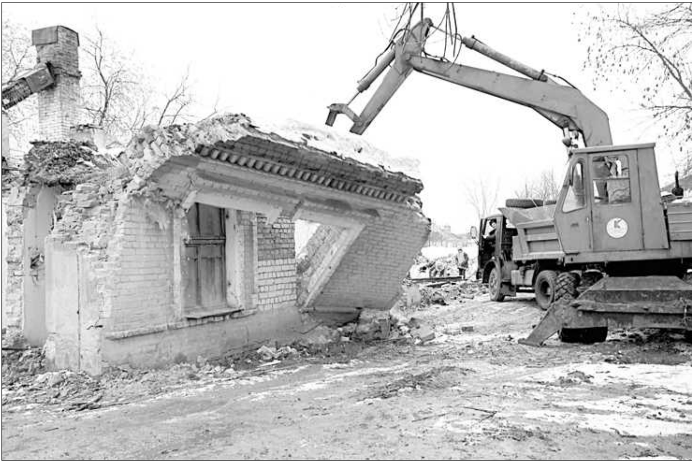
▲ При сносе дома жильцам обязаны предоставить квартиру в том же районе.
