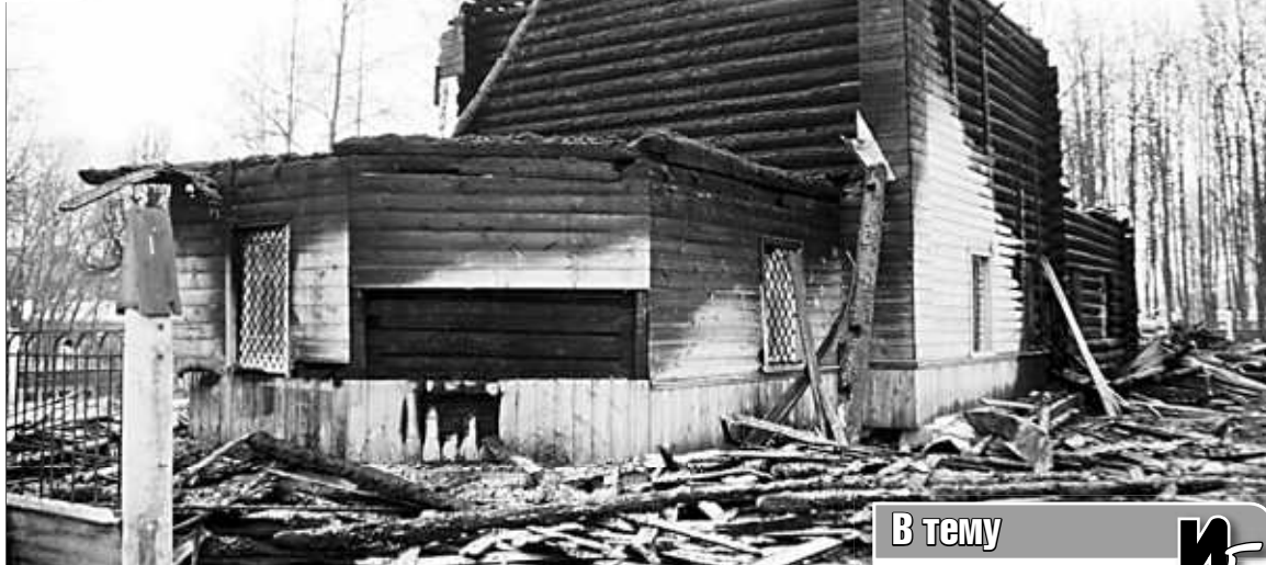
От деревянного здания церкви мало что осталось.
