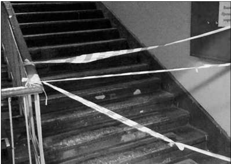
Часть этажа, где произошло обрушение, сегодня полностью закрыта.
