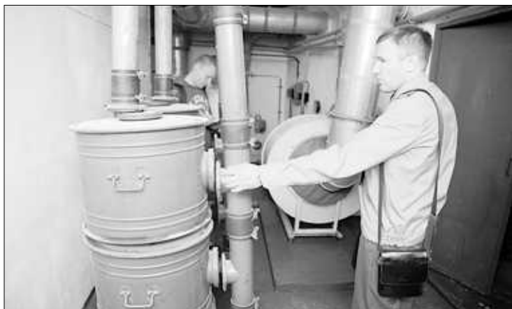
▲ Три системы вентиляции очищают воздух в убежище под ТЭЦ-2.
