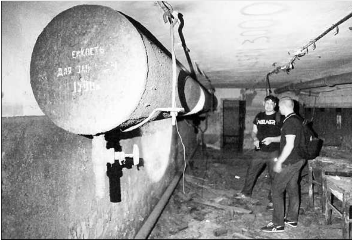
▲ Проржавевший резервуар в убежище на Тимирязева давно не видел воды.
