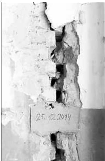
Трещины на стенах шокируют.
